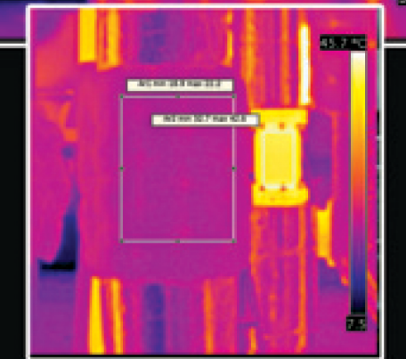
Das Ventil DN 150 an der Rückführung ohne die angebrachte Dämmung.
